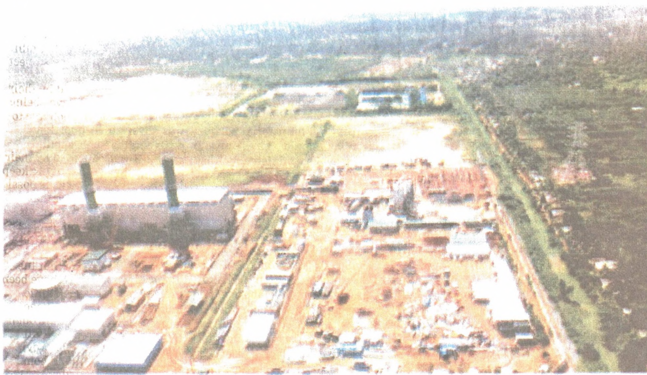
Kerawalapitiya LNG POWER PLANT
